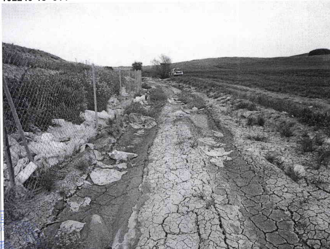
FOTOGRAFÍA N° 7: IMAGEN DE OTRA ZONA DEL CAMINO CON RESIDUOS SOBRE EL MISMO.
